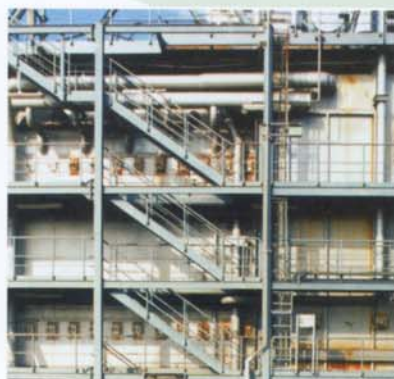
Nachbrennkammer mit Dampfkessel
